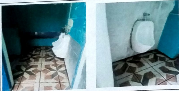
Foto 3: MODULO A Servicio Sanitario. Suministro e Instalación de piso ceramico + instalación de urinarios individuales con aplicación de azulejo en urinario colectivo existente.
